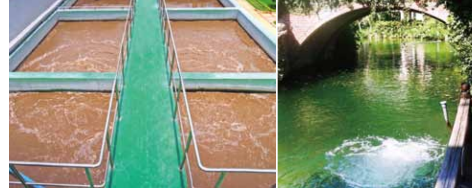
Planta de Tratamiento de agua : Instalados a 4.5m de profundidad.
